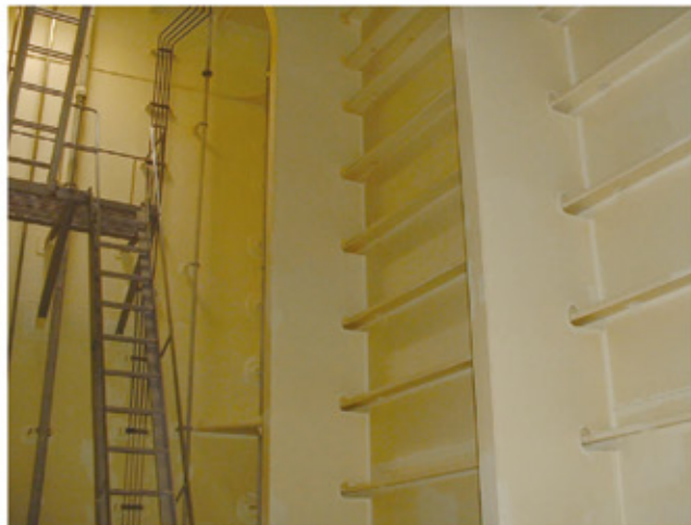
[仕様]ニッペエポキシ PC NOA クリーム 125 \mu m \times 2coat [解説]塗装後、30ヵ月後の状態、錆、腐食無く良好な状態
